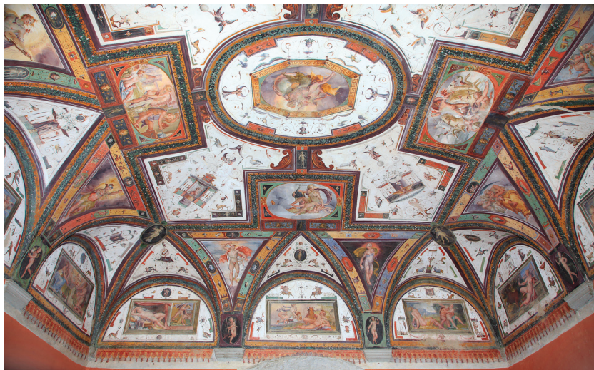
Fig. 23 - S. Giustino Umbro, Castello Bufalini. Soffitto a calotta dipinto da Cristofano Gherardi.
